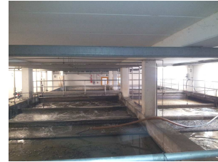
Immagine dell'impianto di depurazione (foto Comunità Comprensoriale Valle Isarco)
