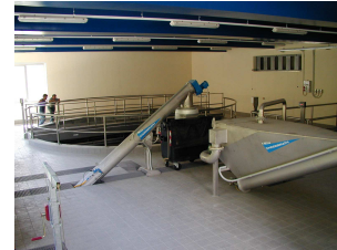
Immagine dell'interno dell'impianto di depurazione
