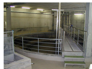
Immagine dell'impianto di depurazione
