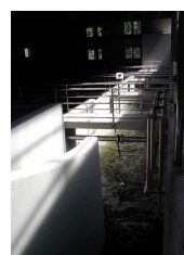
Immagine dell'impianto di depurazione
