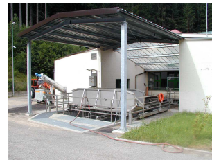
Immagine dell'impianto di depurazione
