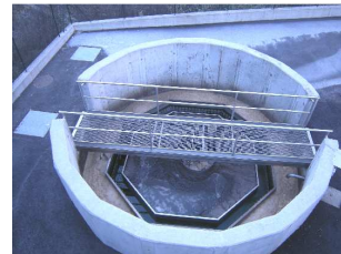
Immagine dell'impianto di depurazione
