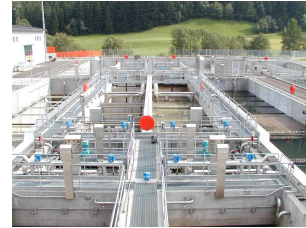
Immagine dell'impianto di depurazione
