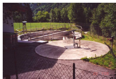
Immagine dell'impianto di depurazione
