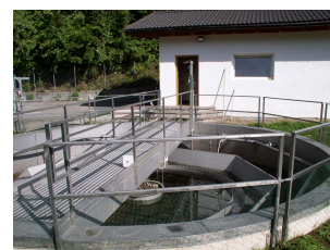
Immagine dell'impianto di depurazione
