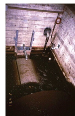
Immagine dell'impianto di depurazione
